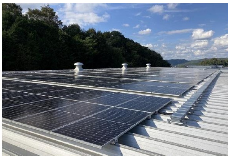
東海化成工業御嵩工場に設置した太陽光発電パネル
